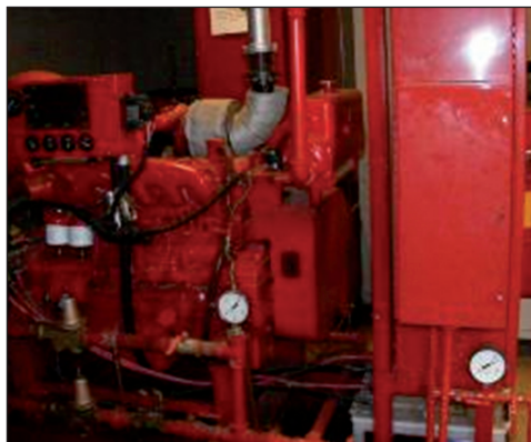
6. ábra: Tűzvízszivattyú (a szerző felvétele)
